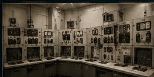
Consola principal de control e instrumentación del reactor RA-2.
